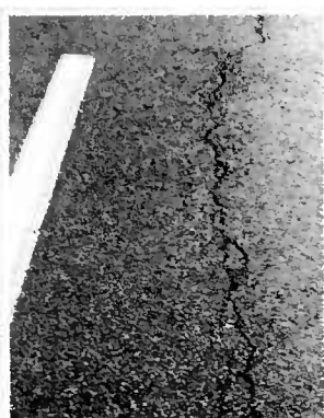
Fissure longitudinale dans les bandes de roulement
